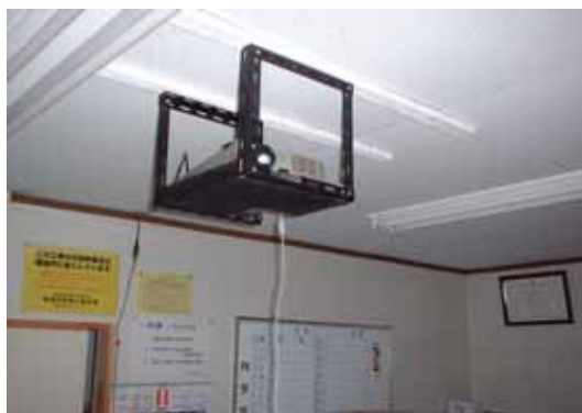
会議室に天井プロジェクターを設置
