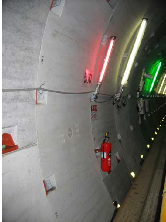
消火器位置を示す蛍光灯
